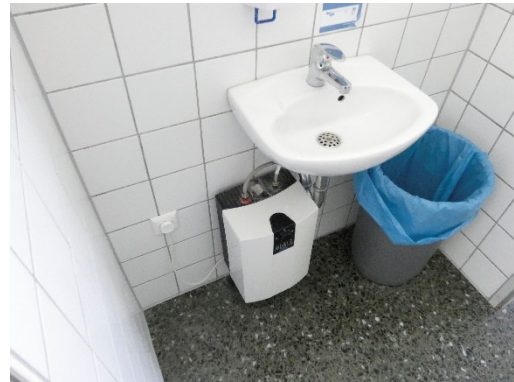
Abbildung 86 – Geb. E, Warmwasserbereitung in den WCs
