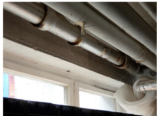
Abbildung 84 – Geb. E, Korrosion + Undichtigkeiten
