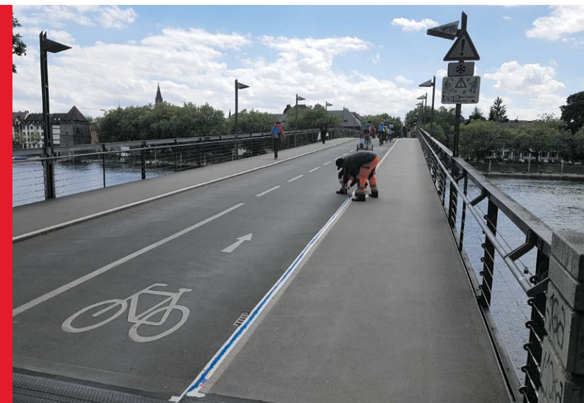
Die Kante zwischen Rad- und Gehweg auf der Fahrradbrücke hat eine auffällige, blaue Markierung bekommen. Die Markierung soll den Höhenunterschied zwischen Rad- und Gehweg besser sichtbar machen und so Stürze verhindern. Die Fahrradbrücke wird von rund vier Millionen Radfahrenden pro Jahr genutzt. Das Streichen haben die Technischen Betriebe Konstanz übernommen.
