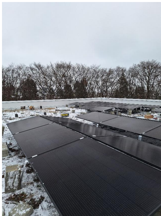
Abbildung 22: PV-Anlage auf Kernzeit Wollmatingen
