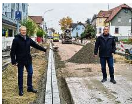
Bürgermeister Karl Langensteiner-Schönborn (links) und Bauleiter Peter Martin freuen sich über den Baufortschritt in der Fürstenbergstraße. Hier am Übergang vom fertigen ersten Bauabschnitt zum zweiten. BILD: STADTVERWALTUNG
