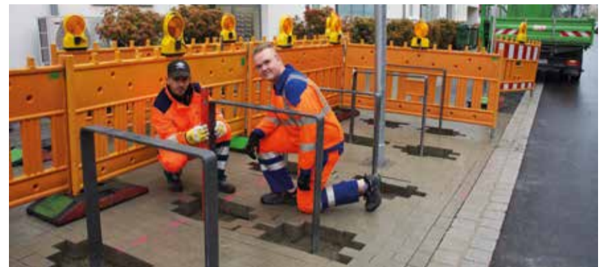
Sanierung der Bruder-Klaus-Straße auf der Zielgeraden: Mitarbeiter der TBK (im Bild zu sehen: Umberto Petricciuolo und Nic Kummer) installieren rund 80 neue Fahrradbügel in der Bruder-Klaus-Straße. Damit wird die Sanierung der Straße in den kommenden Wochen abgeschlossen. Um den Jahreswechsel wurden bereits 20 neue Bäume gepflanzt, überwiegend eine Lindenart. Die reinen Tief- und Straßenbauarbeiten gingen ca. 8,5 Monate und beinhalteten auch die Erneuerung von Gas- und Wasserleitungen sowie die Verlegung von Glasfaserleitungen und die Einrichtung zweier Parkplätze mit einer Ladestation für E-Autos.
