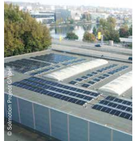
Die PV-Anlage auf dem Dach der Schänzle-Halle ist eine von 13 neuen Anlagen, die aus den Mitteln des Bürgerdarlehens realisiert werden.
