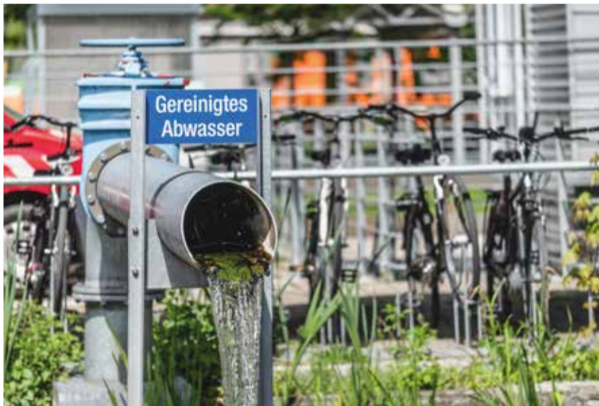
Das gereinigte Abwasser
