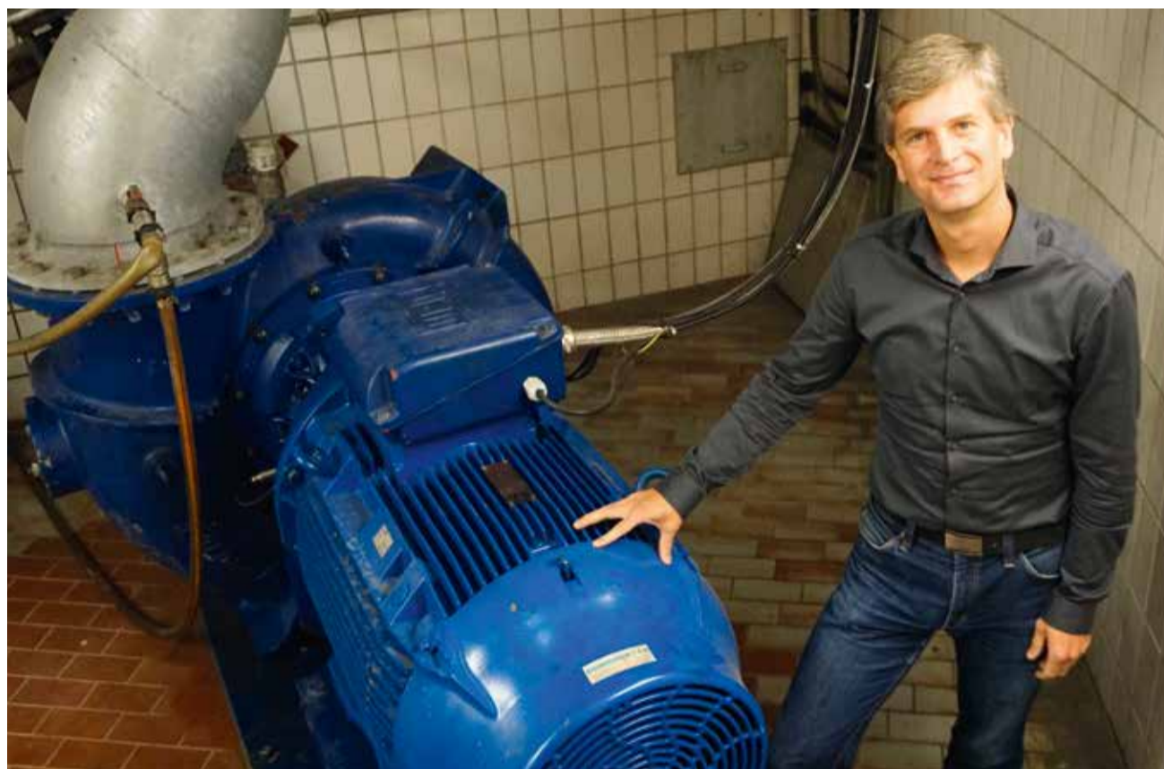
Mirco Ebeling befindet sich im Inneren der Zulaufpumpstation, in der alles zufließende Abwasser in die Kläranlage gepumpt wird. Nach Passage des Zulaufpumpwerkes durchfließt das Abwasser im freien Gefälle die erste mechanische Reinigungsstufe bestehend aus der Rechenanlage und den Sand- und Fettfängen.
