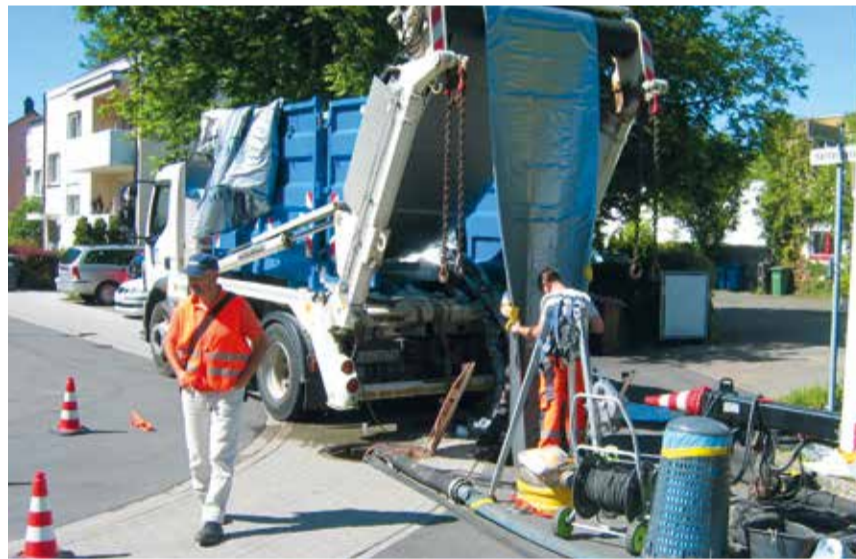
In der Harder Gasse wurde 2017 der Kanal in der geschlossenen Bauweise saniert – im grabenlosen Schlauchliningverfahren.
